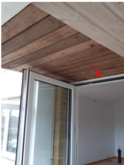
Fuge over dør skal være synlig
